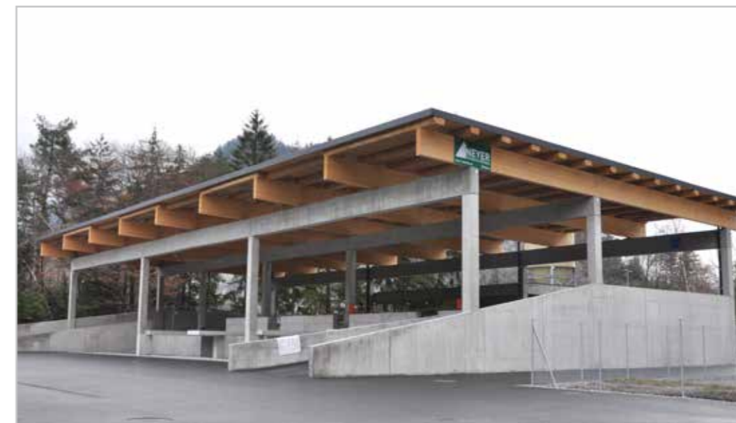
Der Bau des neuen Altstoffsammelzentrums ist schon in der Endbauphase. Der erste Betriebstag ist am 23. Februar 2015.
